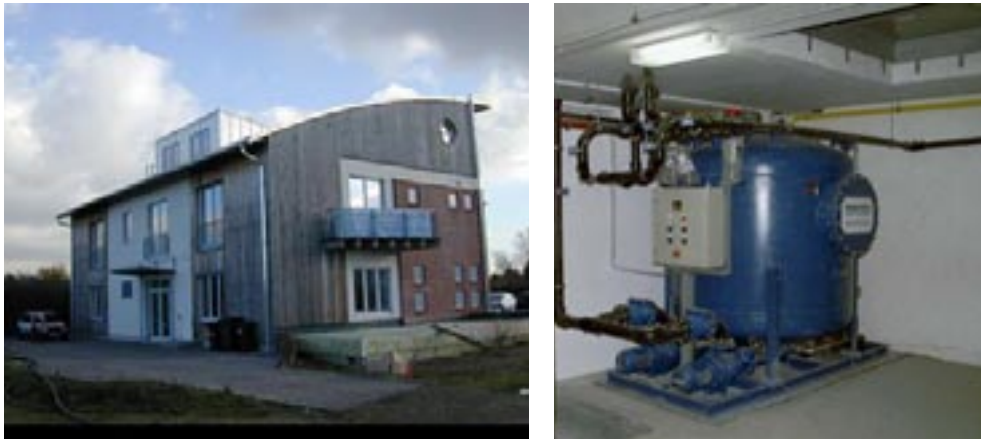
FIGUUR 12 GEScheiden INZAMELING VAN ZWART WATER IN DE DUITSE STAD LÜBECK; LINKS: CENTRAAL GELEGEN WIJKGEBOUW MET VERGISTINGSRUIMTE IN DE KELDER; RECHTS: VACUÛMINZAMELINGSTATION VOOR DE WIJK
