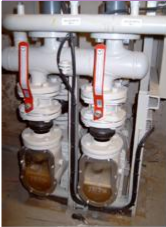
Figuur 15 Voorbeeld vacuümstation
