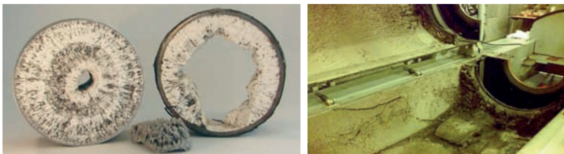
FIGUUR 1 AFZETTINGEN LEIDINGWERK EN CENTRIFUGES SLIBVERWERKING
