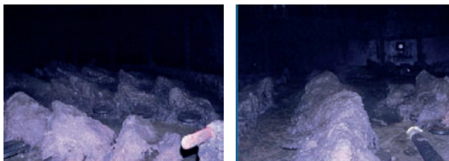
FIGUUR 9 STRUVIET IN DE BUFFERTANK RWZI WASSMANNENDORF (BERLINER WASSERBETRIEBE)
