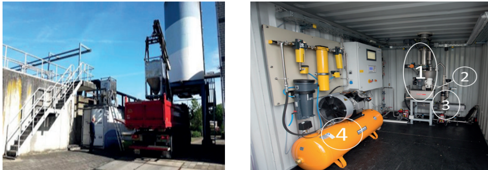
FIGUUR 6 HET WISSELEN VAN DE VOORRAADVATEN (L); DE OPBOUW VAN DE PAK DOSEERINSTALLATIE (R)
