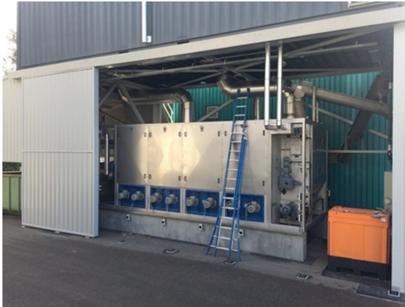
FOTO VAN DE OPSTELLING VAN DE BANDDROGER OP RWZI EDE
