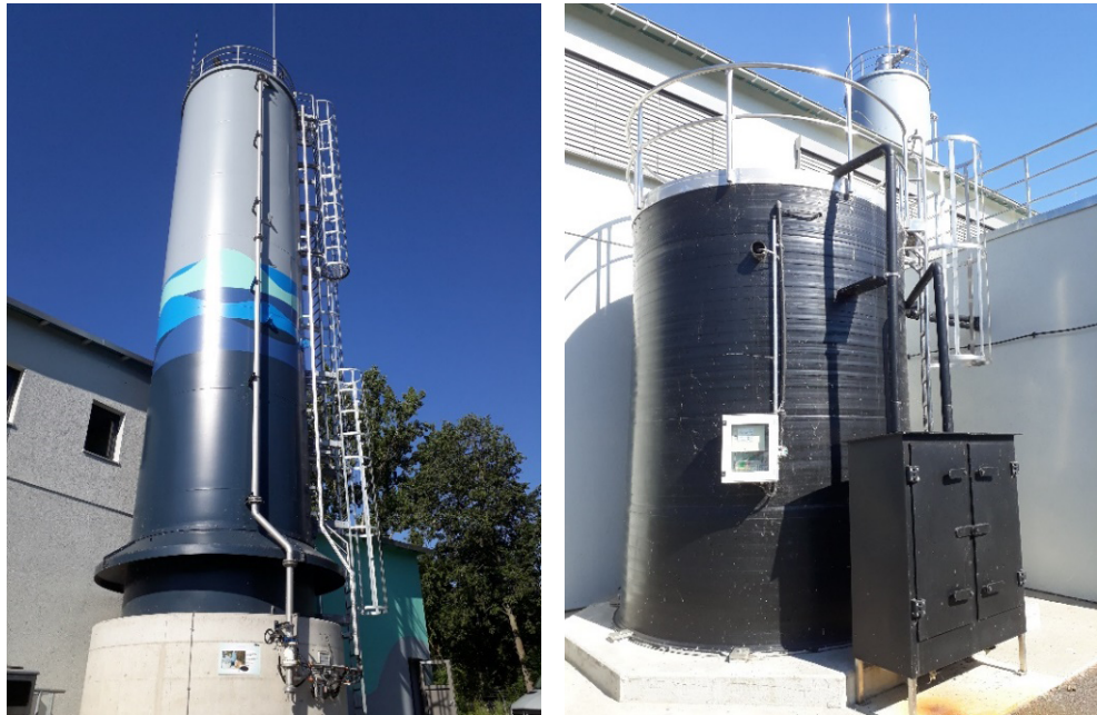
FIGUUR 9 OPSLAGSILO EN DOSEERINSTALLATIE IN BETONWERK POEDERKOOLOPSLAG (LINKS) EN OPSLAG METAALZOUT (RECHTS) WENDLINGEN
