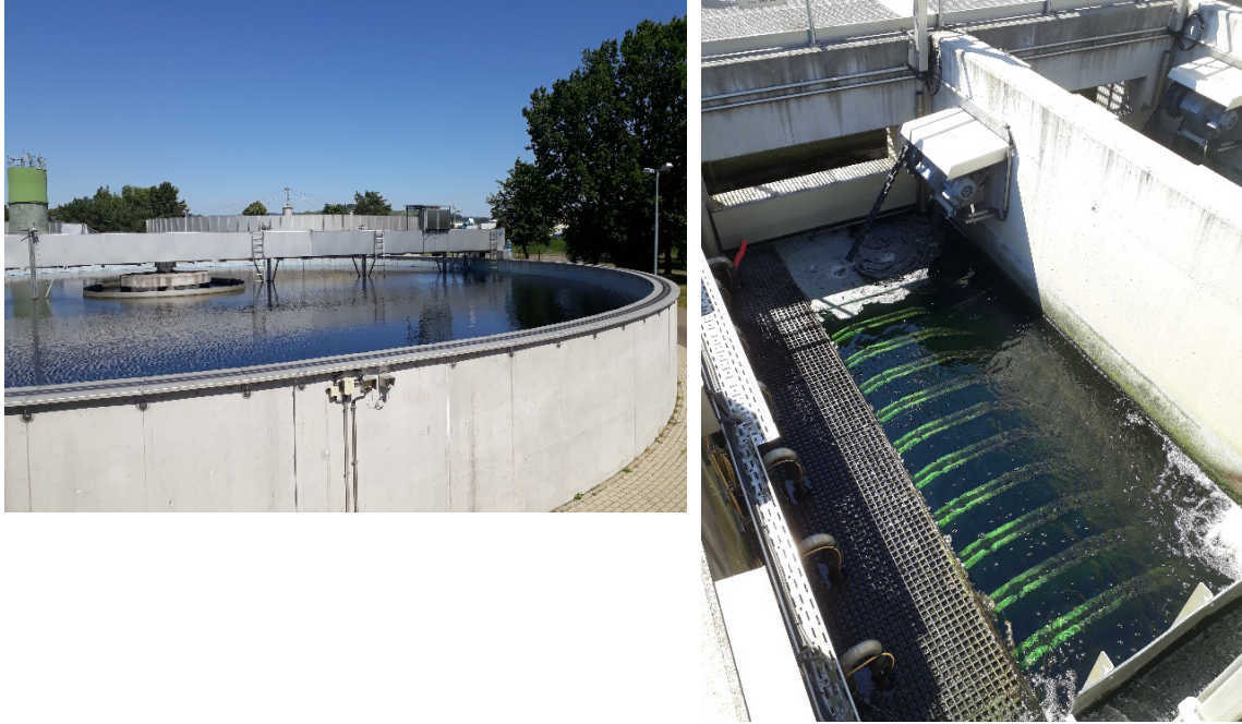
FIGUUR 14 BEZINKTANK NA CONTACTTANK (LINKS) EN DOEKFILTER LAHR (RECHTS)
