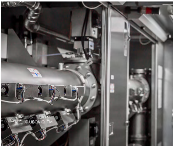
INSTALLATIE USONIQ TECHNOLOGIE (BRON: LEVERANCIER)
