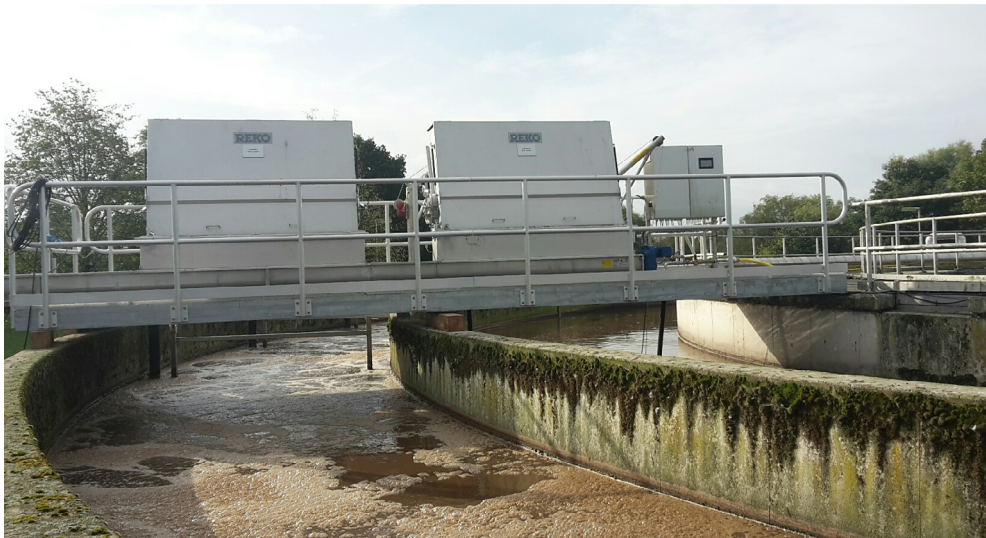
ZEEFBOCHTEN MET TRANSPORTSCHROEF OP BORDES GEÏNSTALLEERD OP RWZI OMMEN
