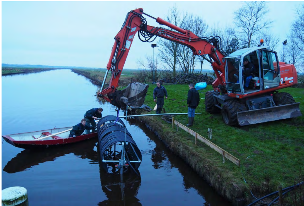
TEO-INSTALLATIE IN DE TSJONGER (BRON: BEWONER)
