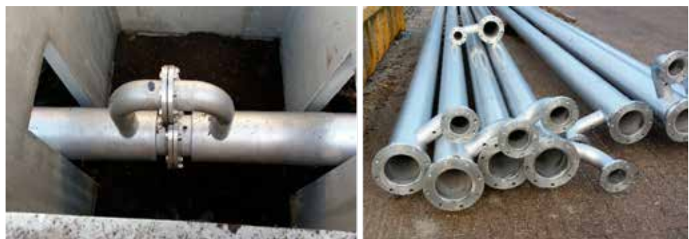
Figuur 2.7 Persleidingrioolwarmtewisselaar extern prefab, waarbij een dubbelwandige buis zorgt voor de warmteoverdracht (Bron: Syntraal)
