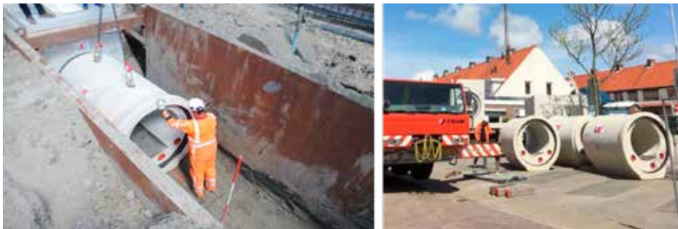
Figuur 2.4 Interne vrijvervalrioolwarmtewisselaar prefab in de gemeente Goes (Bron: warmtepompen.nl)
